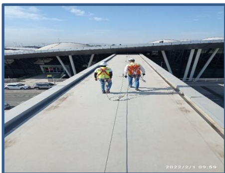
Imagen n° 5 / Visita a cubierta de pasarelas T2M, se verifica limpieza realizada en su oportunidad.
