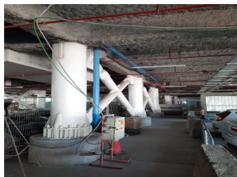
Imagen n°4 / Revisión de piso sala sectores con contrapendientes.
