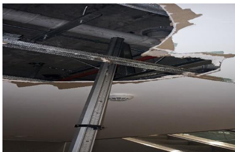
Imagen n°1 / Tubería de largo 0.6 m produce filtración.
